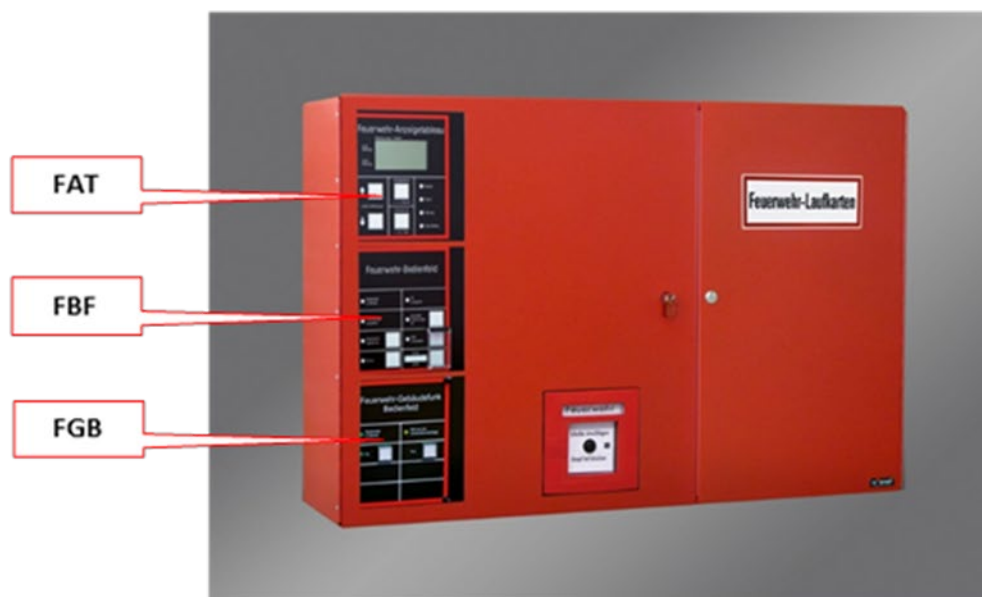
Figure 13 - « Feuerwehreinrichtungs-Zentrale » avec les tableaux FAT, FBF et FGB
