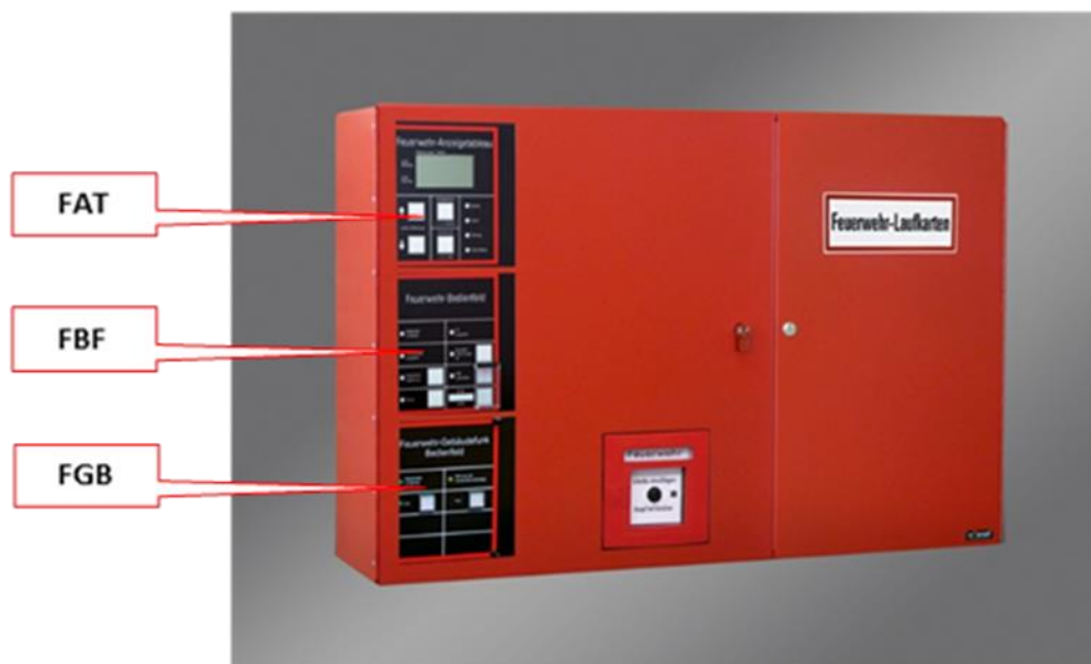
Figure 12 - « Feuerwehr-Informationszentrale » avec les tableaux FAT, FBF et FGB
